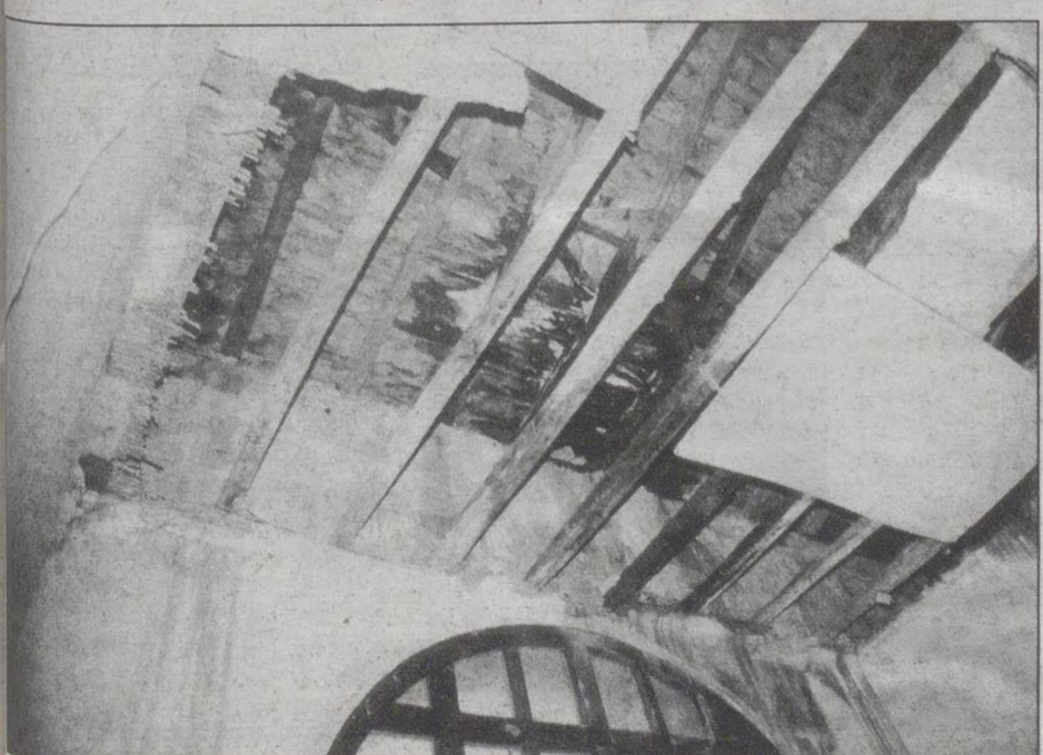
La estructura de madera está a punto de ceder.
