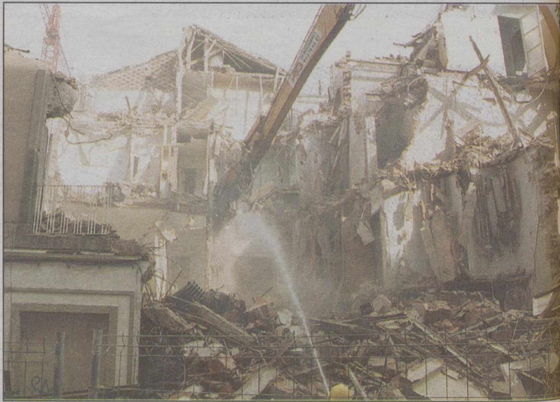
La fachada de la calle Isaac Peral, que se convertirá en peatonal, será el vestíbulo del Teatro Circo.
