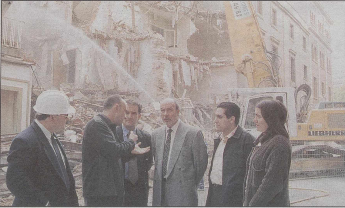
Con el edificio derruido al fondo, el alcalde señaló la Feria del 2002 como la fecha de apertura del Teatro Circo.
