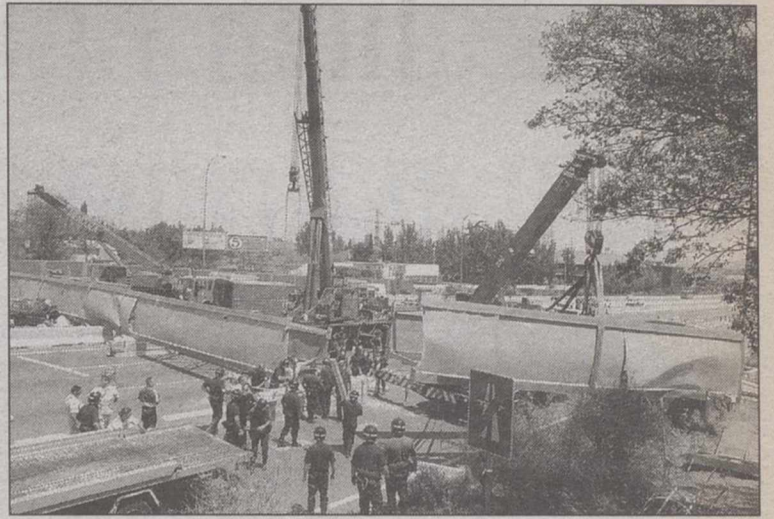
El panel señalizador se desplomó sobre el asfalto.
