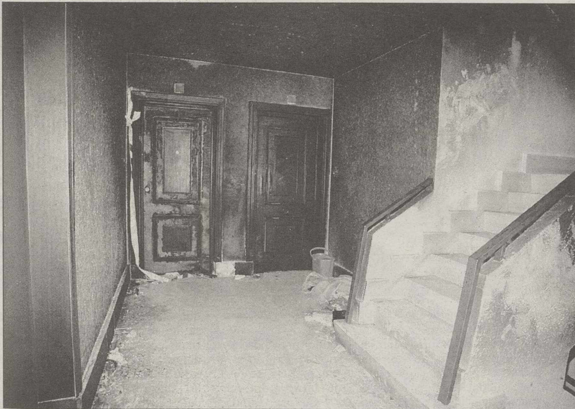
La explosión causó daños de consideración en el rellano de la vivienda.
