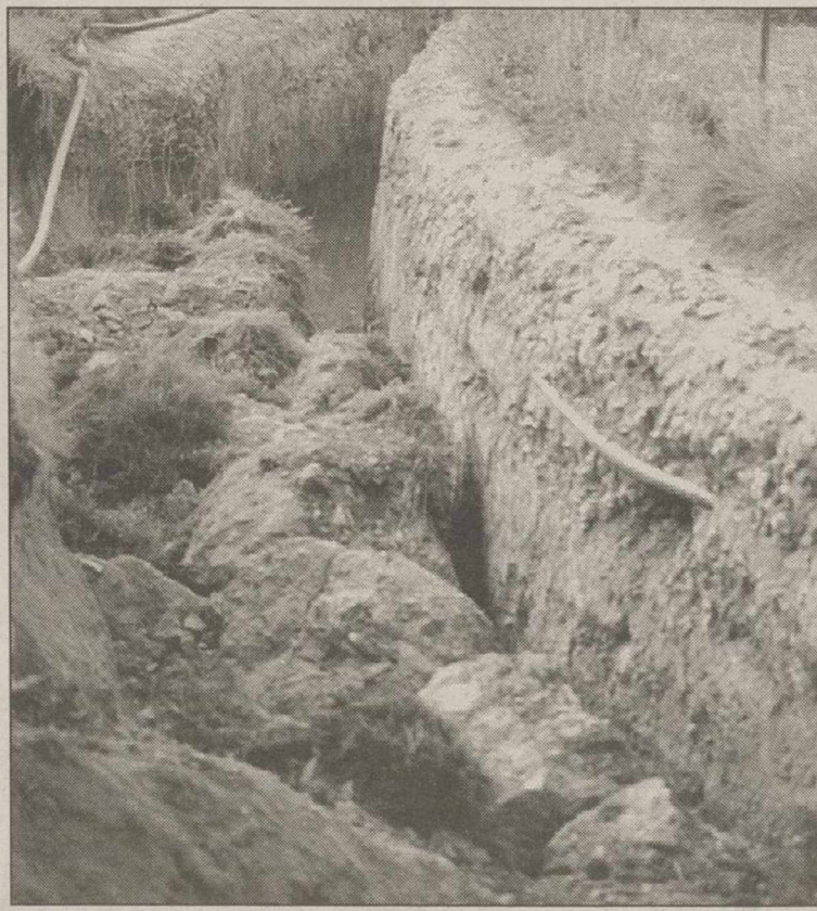
Las obras del colector de "El Palomar" bloquean la entrada a varios chalets.
