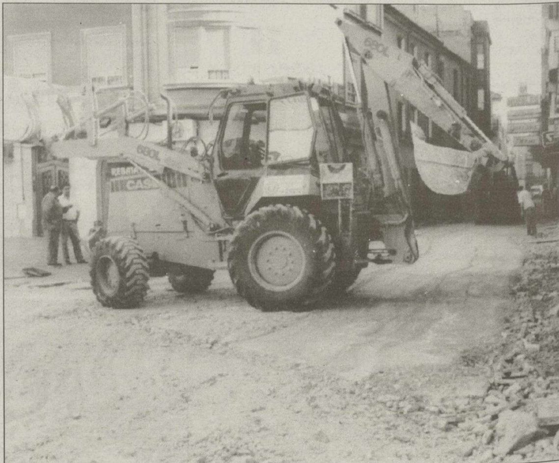
Las obras de renovación del pavimento han comenzado por la calle Zapateros.
