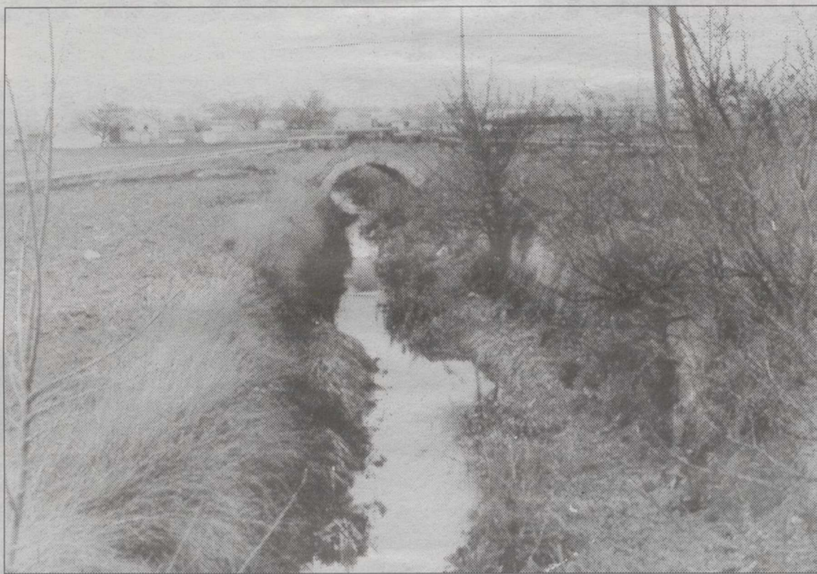
Puente sobre el río Valdemembra a su paso por la localidad de Tarazona de la Mancha.
