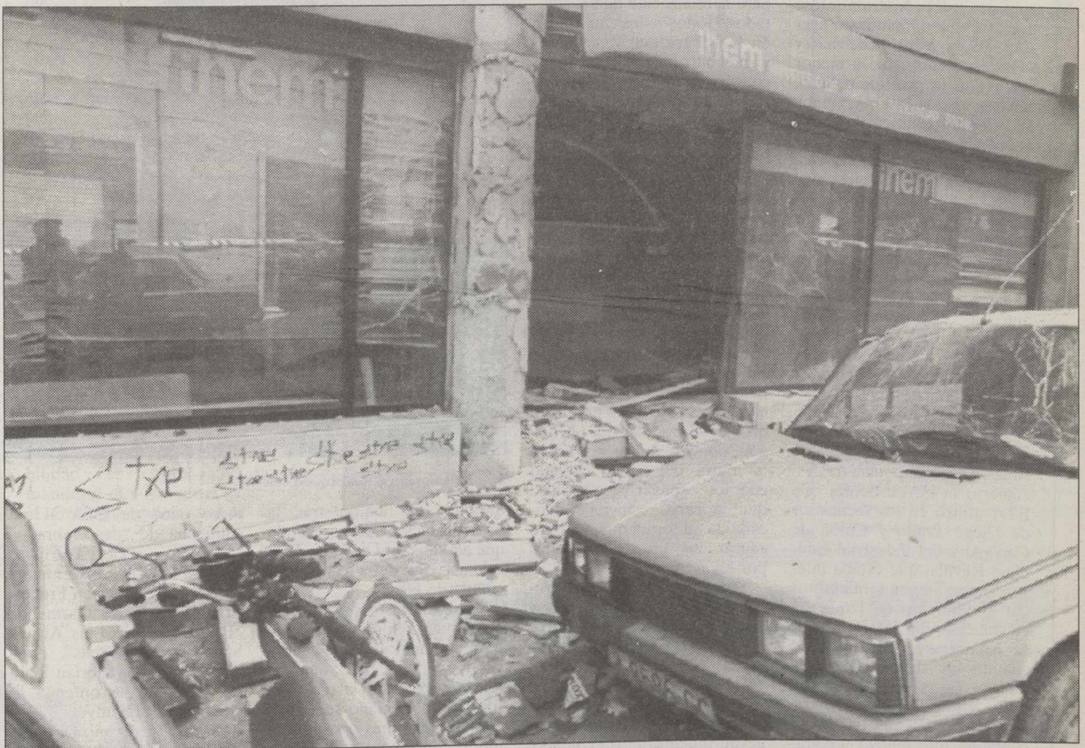
A raíz de la explosión, la entrada a la oficina quedó destruida, mientras que diversos vehículos estacionados en las inmediaciones sufrieron daños.
