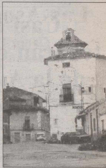
La Torre puede ser demolida.
