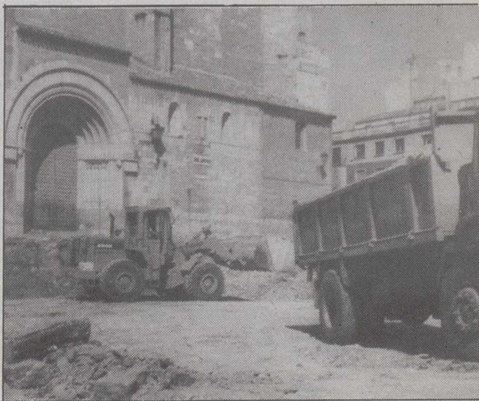
El gran "socavón" está esperando su solución.
