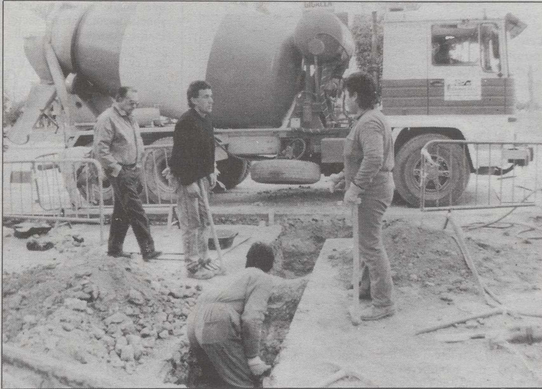
Las obras de apertura de zanjas comenzaron el pasado mes de octubre.
