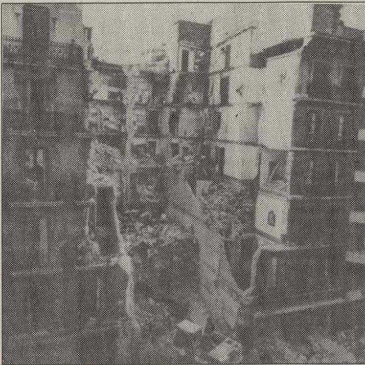
Aspecto de la vivienda derrumbada el pasado miércoles en Barcelona.
