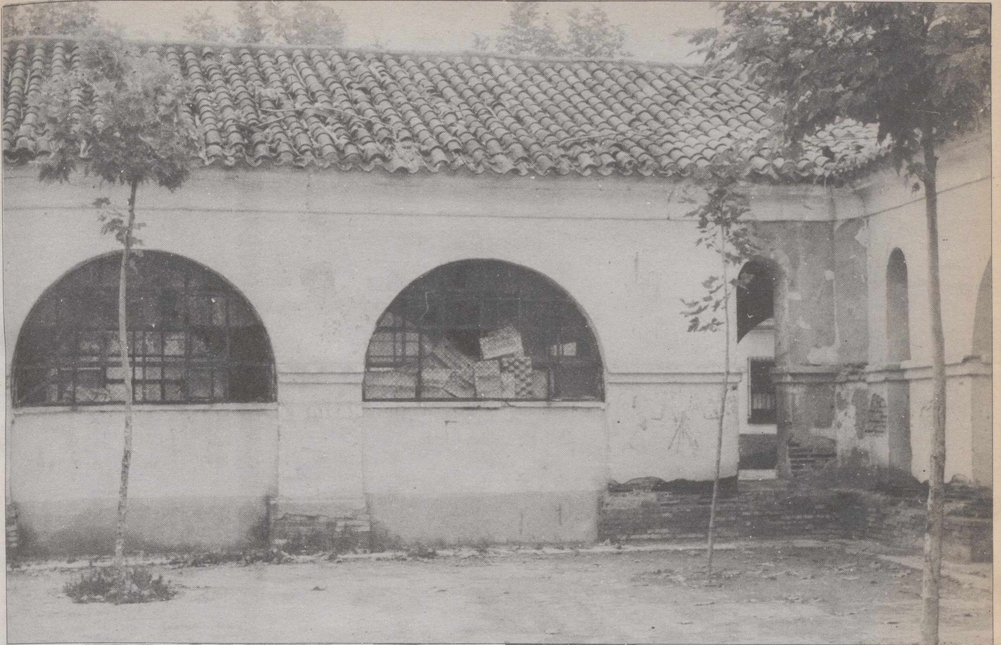
Una imagen que dice todo sobre el estado de las instalaciones del Mercado de las Casas Baratas. JESUS MORENO
