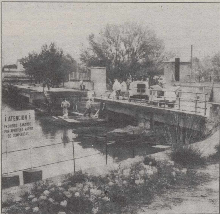
El consejero visitó las obras del nuevo puente de Villalgordo del Júcar.
