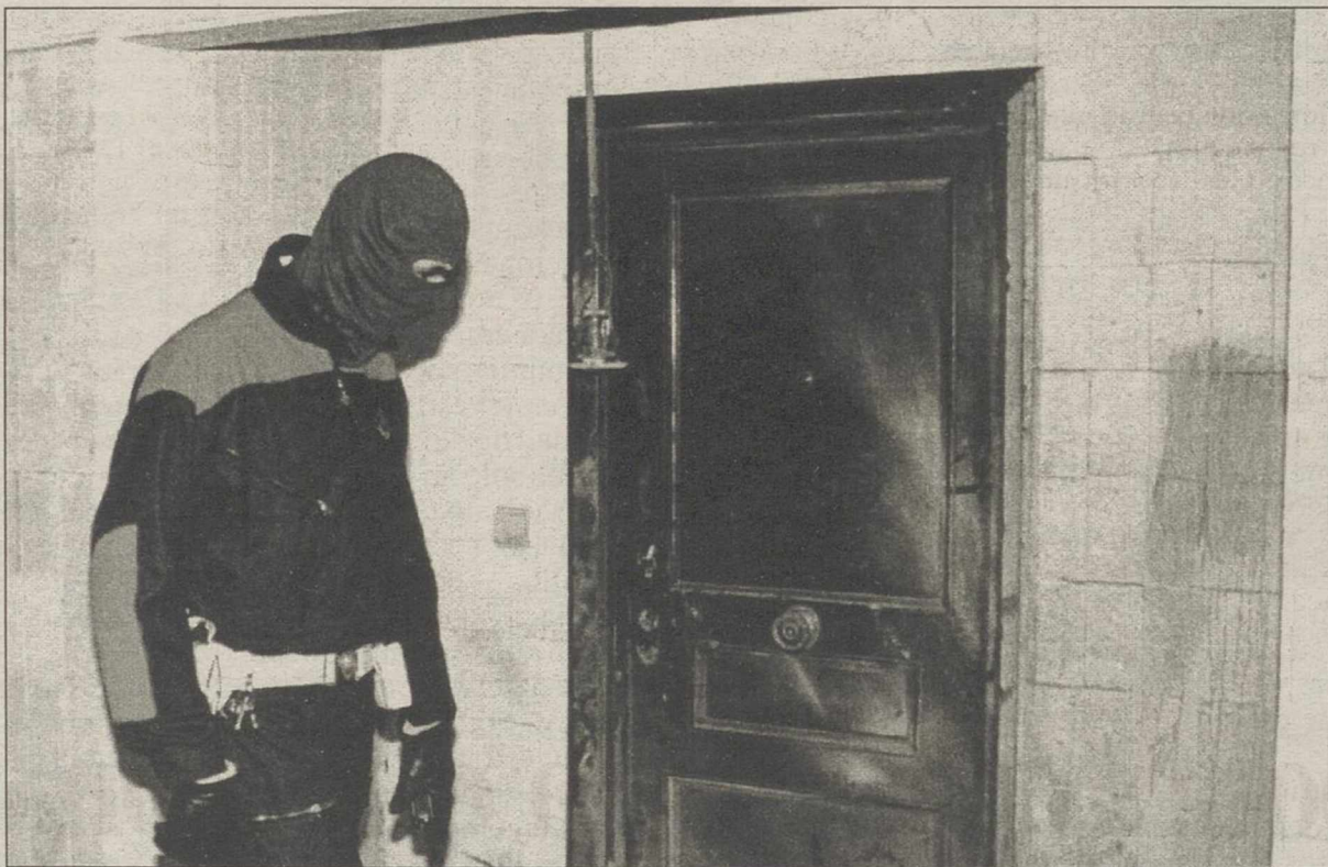
Un agente inspecciona los daños producidos por la explosión en una vivienda.
