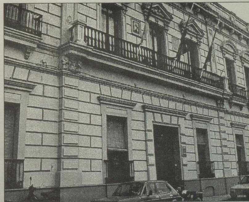
El Ayuntamiento pide que reparen la cubierta del edificio.
