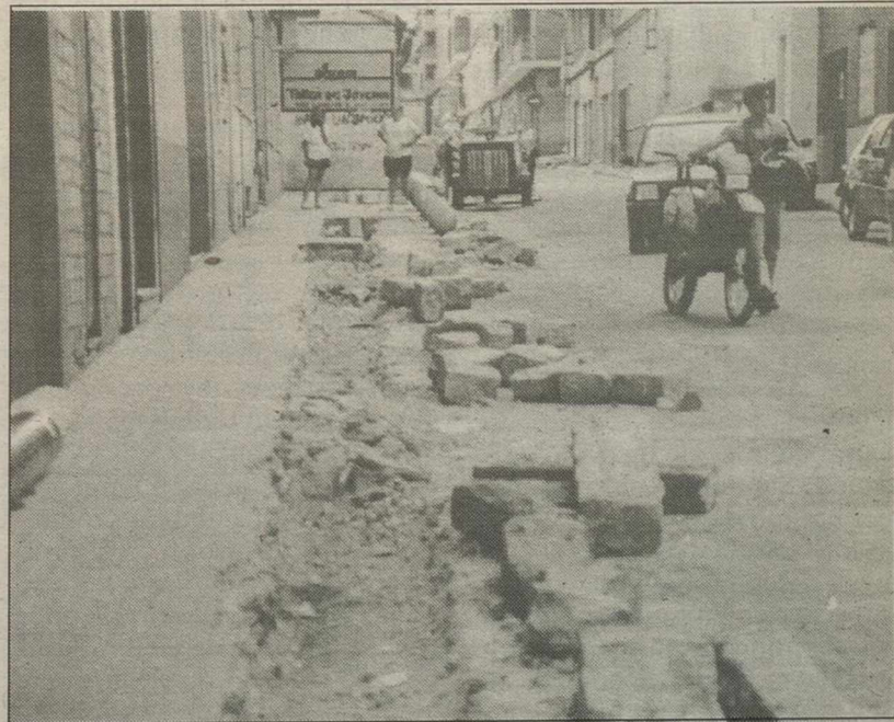
Las roturas en la red son bastante frecuentes.
