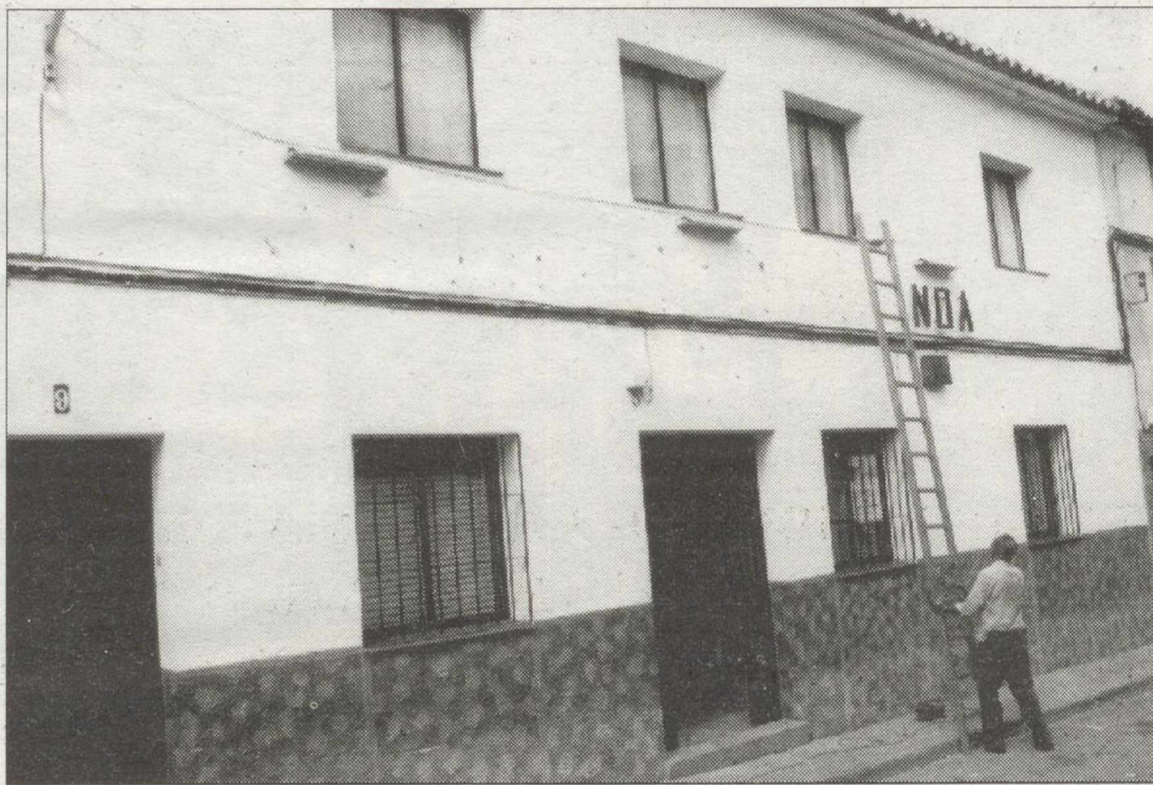
Las obras de las redes de agua y saneamiento están incorrectamente realizadas, según Rodado
