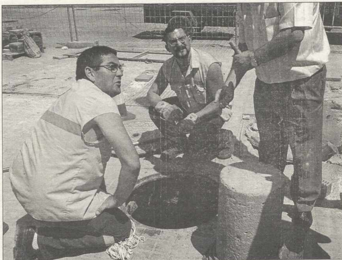
Varios trabajadores inspeccionan la fosa séptica en la que ha muerto un trabajador
