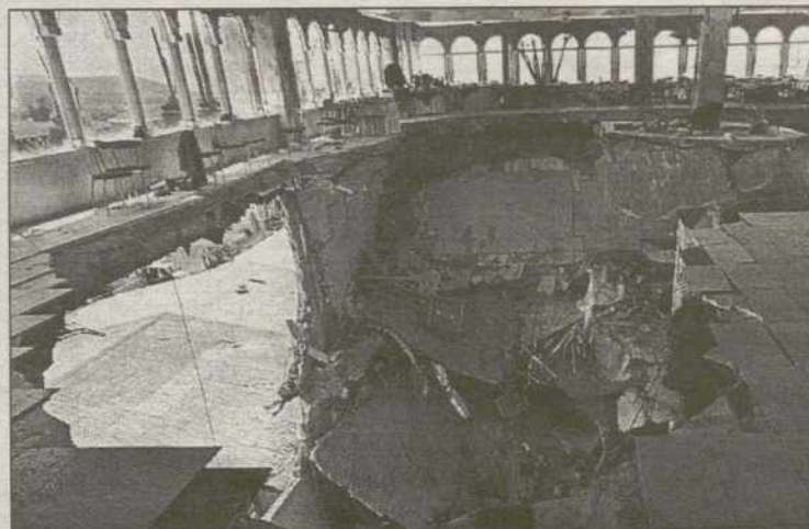
Una cámara de vídeo grabó el hundimiento del suelo
