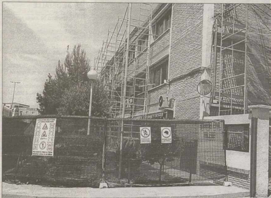
En la fachada principal, se han colocado los andamios para alzar en un piso el inmueble
