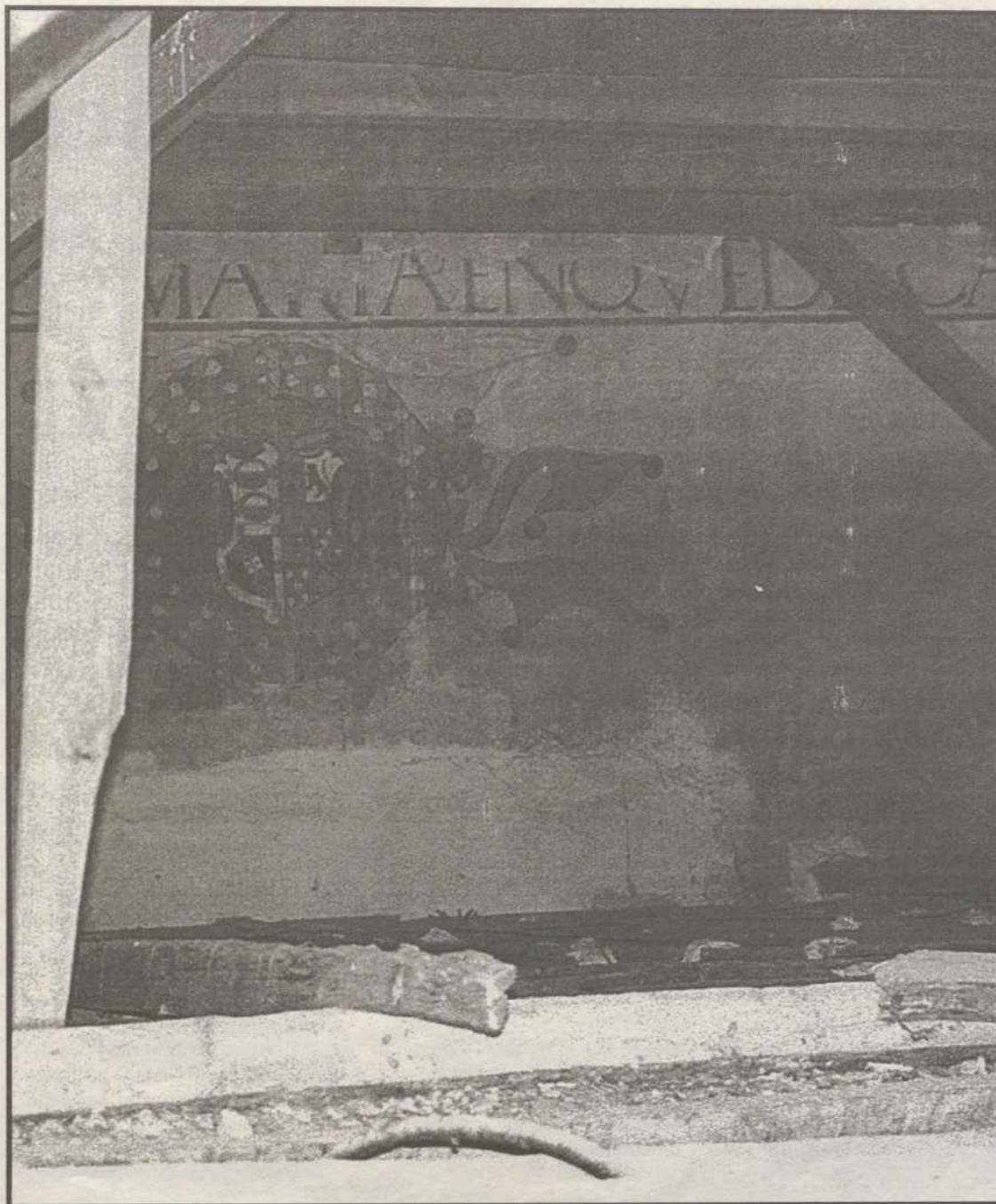
El deterioro de las pinturas se puede observar en la imagen
