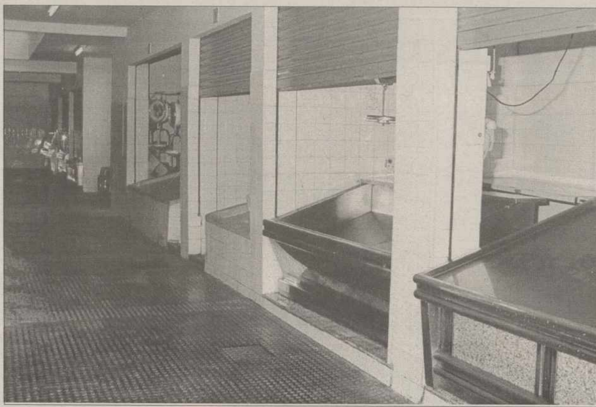
Las instalaciones del Mercado de Abastos se encuentran muy deterioradas.
