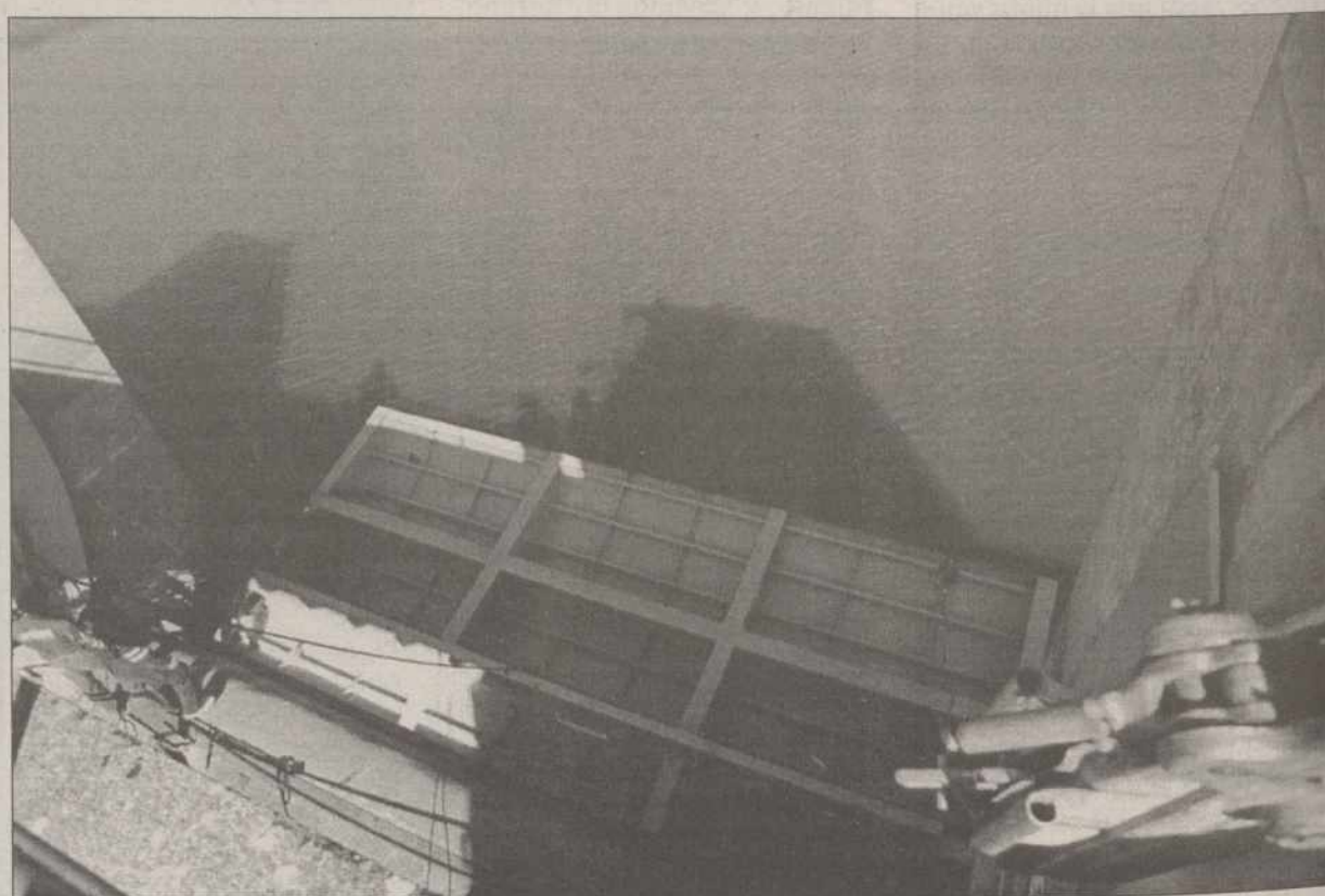
Rivas asegura que desde que concluyó el cambio de la compuerta no se ha bombeado agua al embalse.
