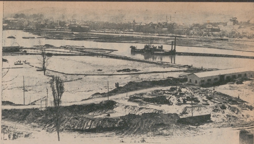
Vista del ángulo norte del terreno que ocupará la Siderúrgica de Avilés, con la draga «Pax» en pleno trabajo de construcción del puerto.
