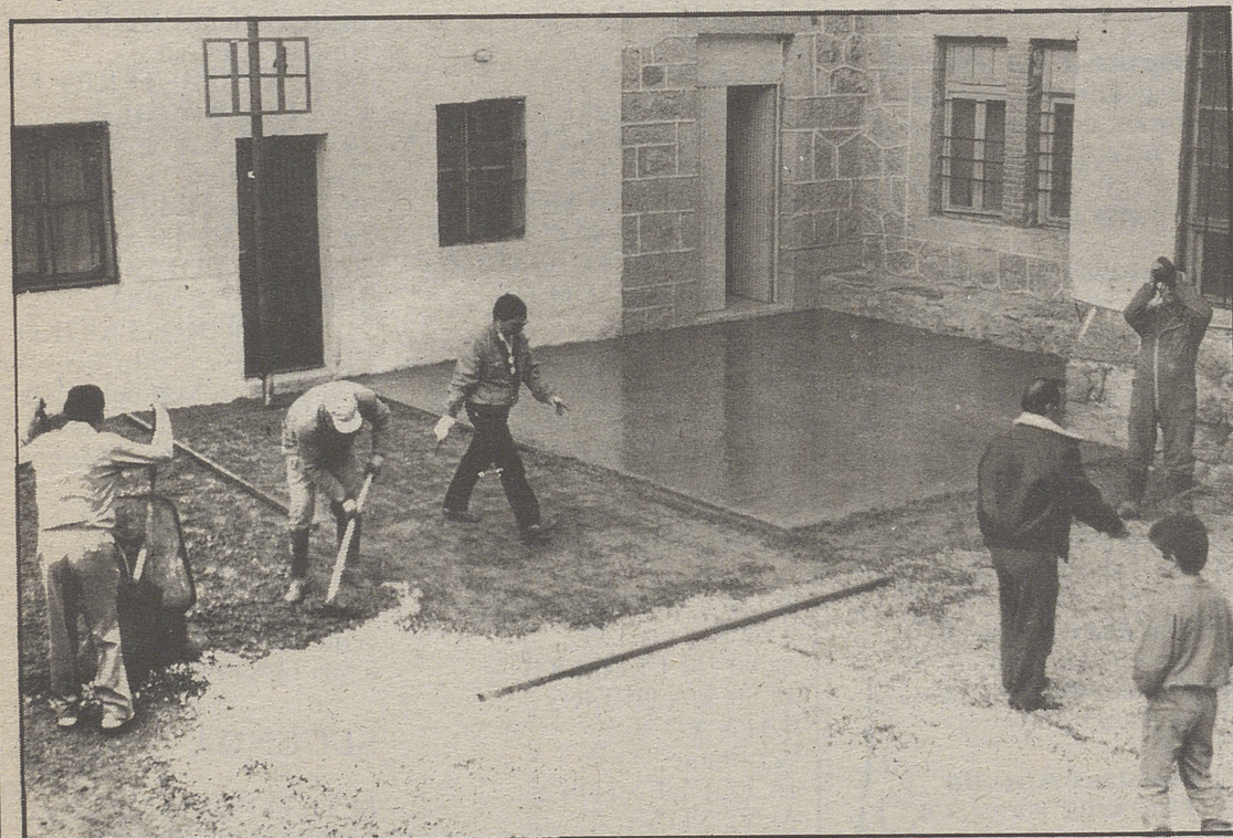
Sobre la solera de grava y las mallas metálicas se extiende el piso de la pista.
