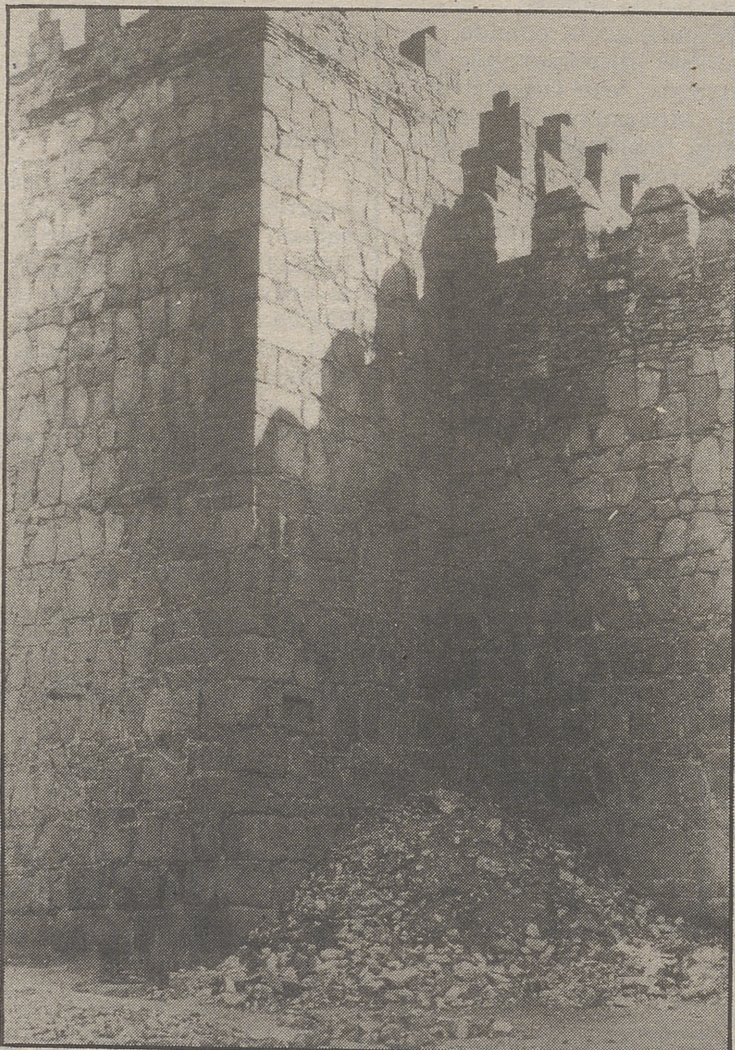
Estos escombros afean la Muralla
