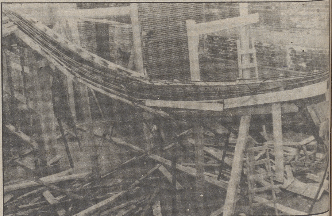
Una viga que los obreros hormigonaban, cayó al suelo arrastrándolo todo.
