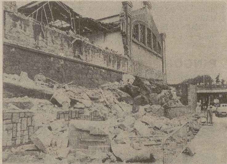
Ya pasó todo. La nave es un montón de cascotes. Sólo una mínima parte cayó al exterior.
