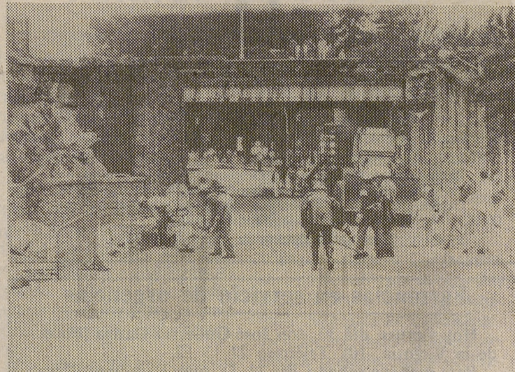
En pocos minutos, la calzada quedó limpia de los escasos cascotes que cayeron sobre ella.
