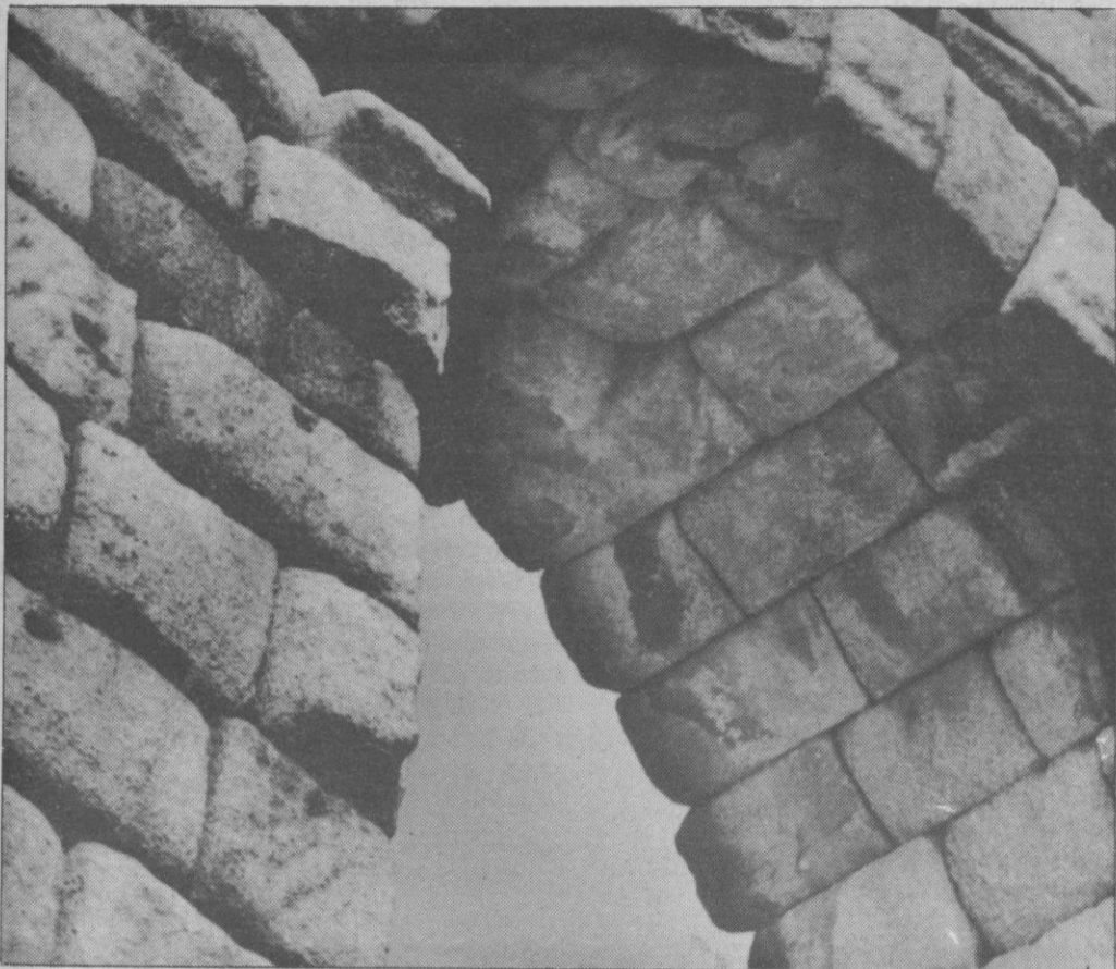
En algunos arcos del Acueducto hay problemas de desprendimientos.
