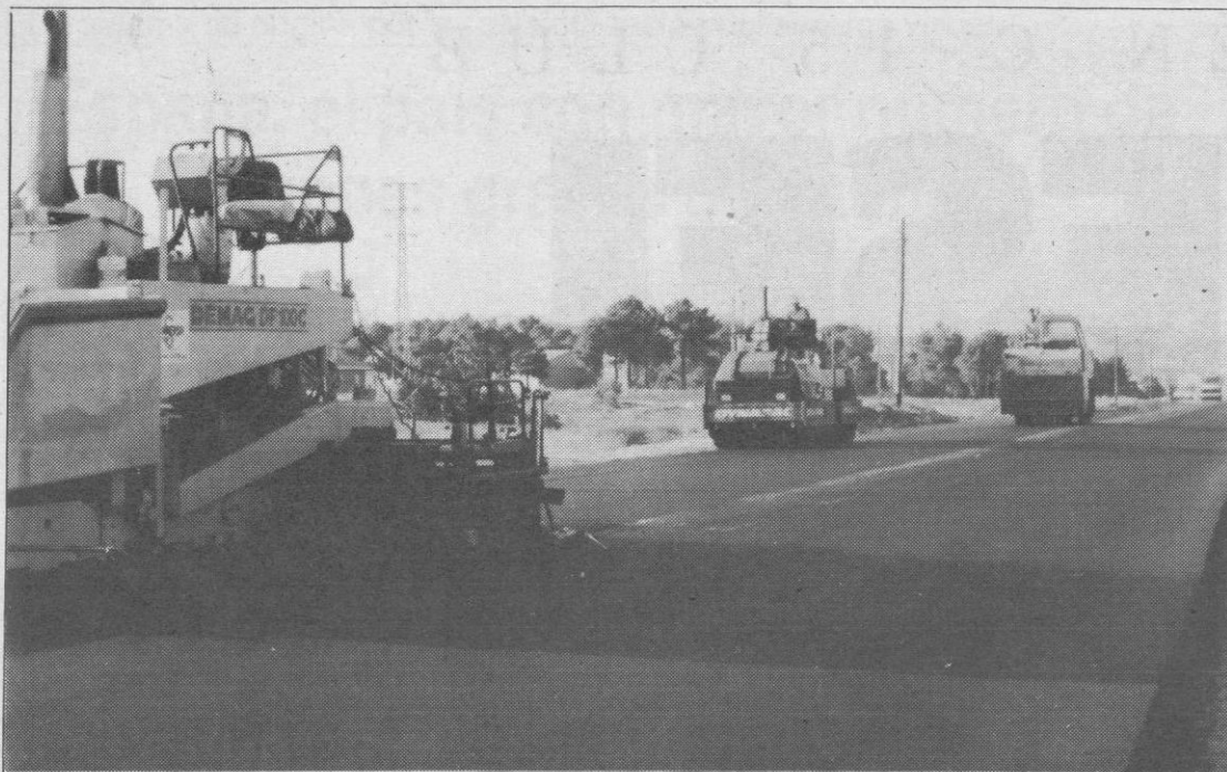
Obras en la carretera a su paso por el término municipal de Cuéllar.
