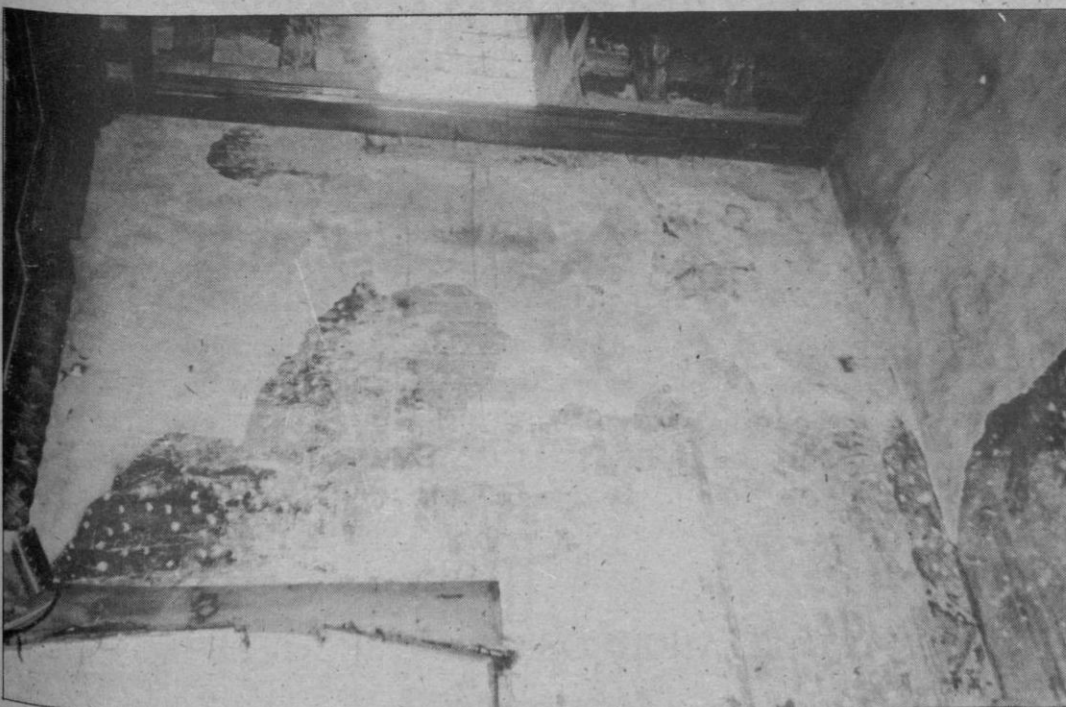
Situación en que se encuentra una de las paredes, donde aparecieron restos de pinturas sobre las que no se ha tomado aún decisión alguna
