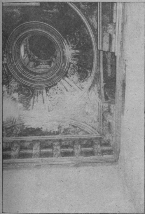
Bóveda del camarín, en la que claramente se observa la pérdida de pintura y otros defectos
