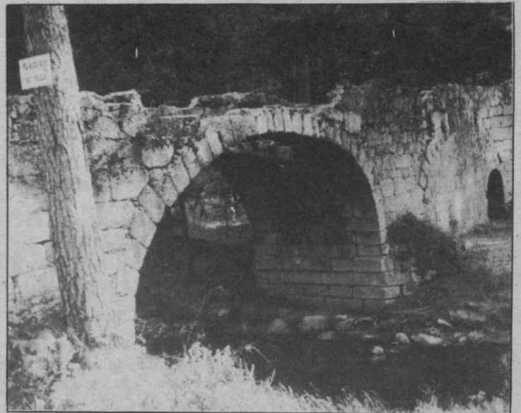
El bello puente romano de Navalcarreta, en cuya parte superior se aprecian los serios desperfectos que sufre.
