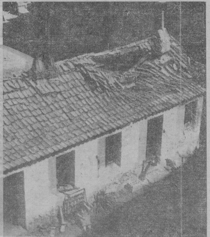
No hay dinero para reparar los daños
