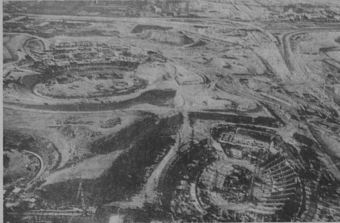
Munich.—Unos mil días antes de la inauguración de los Juegos Olímpicos en Munich (República Federal de Alemania) se hizo esta foto del campo de deportes de dicha ciudad, el llamado Oberwiesenthal. En el primer plano se ve el pabellón de deportes, todavía descubierto, que, a vista de pájaro, causa la impresión de un antiguo anfiteatro. Detrás del mismo a, la izquierda, está naciendo el óvalo del estadio. Quizá visible, igualmente, la red de carreteras con la autopista urbana. Adicionalmente al programa de construcción anterior, el Comité Olímpico de Organización resolvió la instalación de dos centros para el alojamiento de grupos juveniles.—(Foto DaD)
