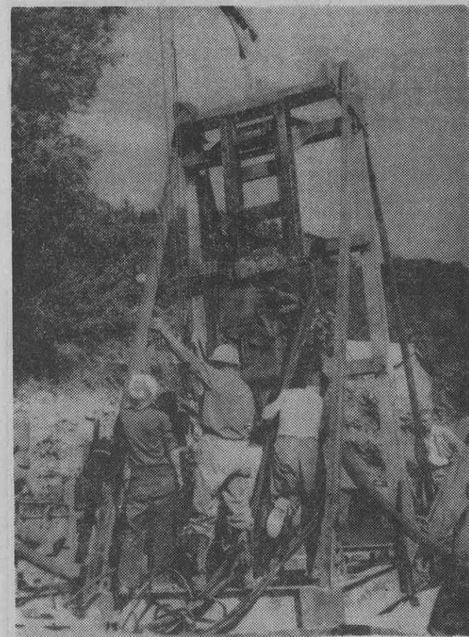
La perforadora vertical sigue su trabajo, pese a encontrar capas de ceno en su camino. (Foto Fiel.)
