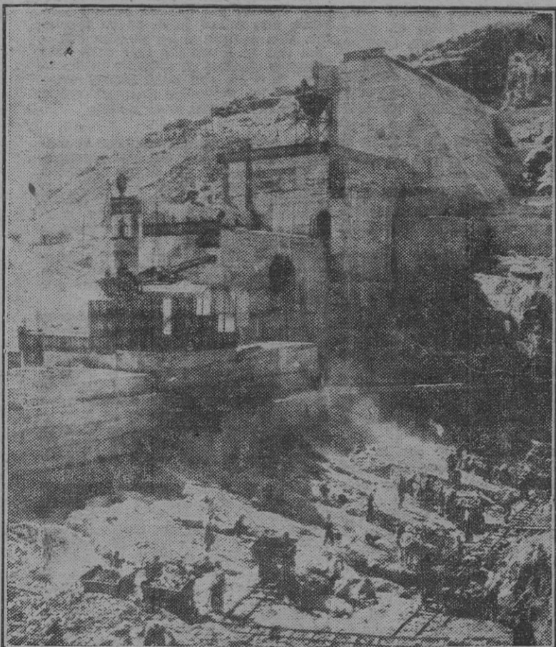
El dique de In-Fouth, que será el mayor de Africa del Norte, pertenece a un sistema de irrigación que, partiendo de un pantano de veinte kilómetros cuadrados, asegurará el riego de 50.000 hectáreas.
