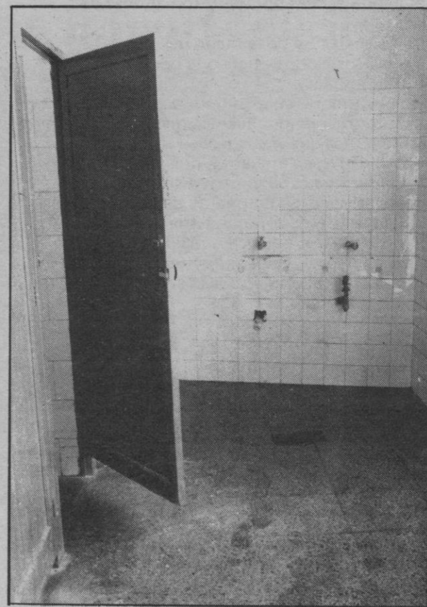
Aunque hoy se inicien las clases, los lavabos del último piso todavía no han sido instalados.
