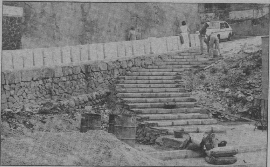
En las inmediaciones de S'Aigo Dolça, se está construyendo, como habíamos informado, una nueva escalera.— (Foto Cosme Vives).
