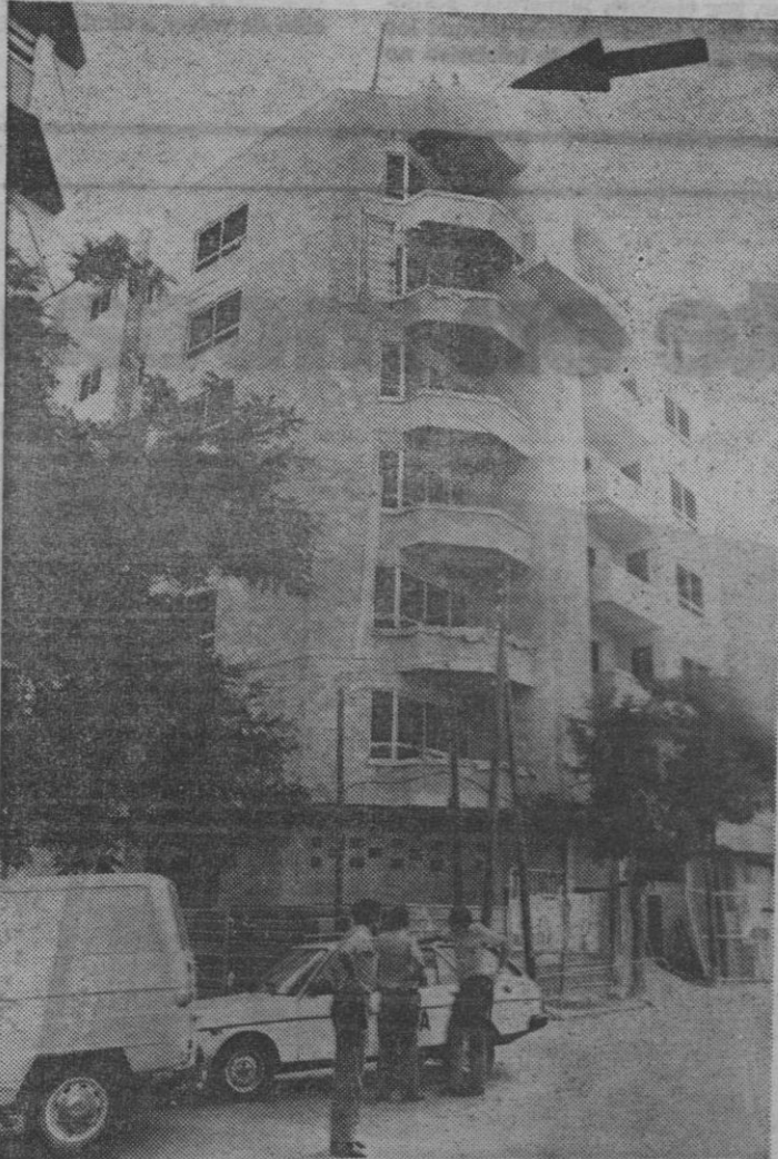
La flecha, sobre la foto de Cosme Vives, señala el andamio desde el cual cayó al vacío un obrero, perdiendo la vida. El suceso ocurrió ayer en la calle de Benito Pérez Galdós.
