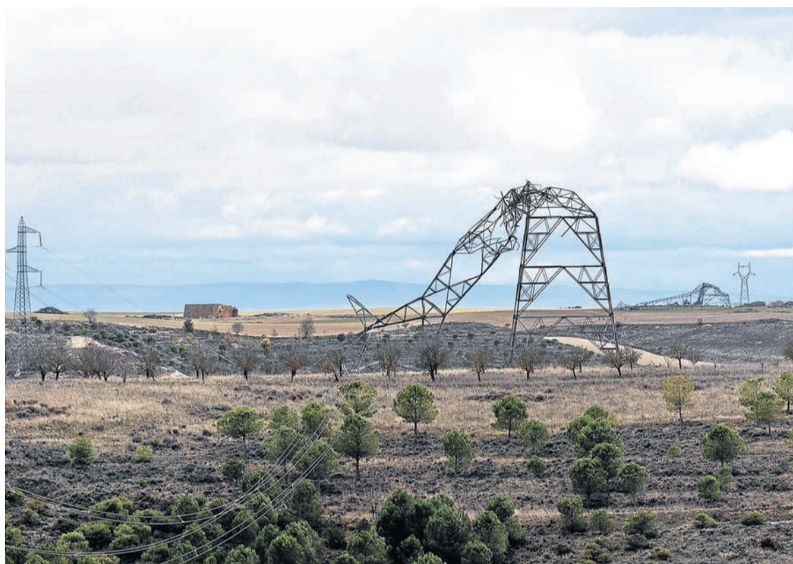
Torretas de transporte de electricidad derribadas ayer por los fuertes vientos en Valladolid.
