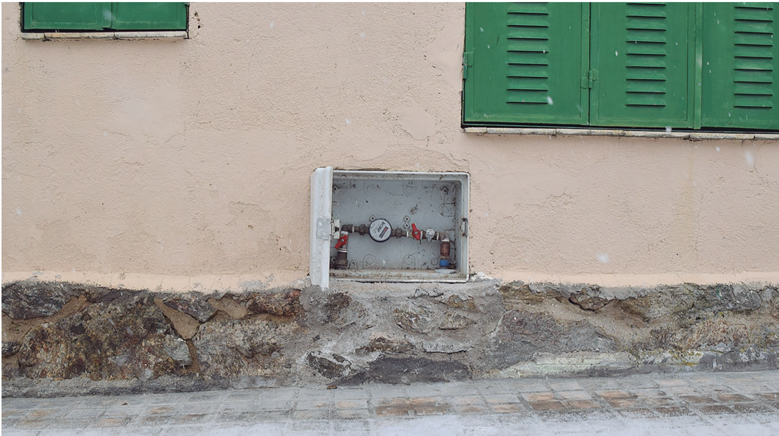
Un contador de agua situado en la fachada exterior de una vivienda en Revenga.
