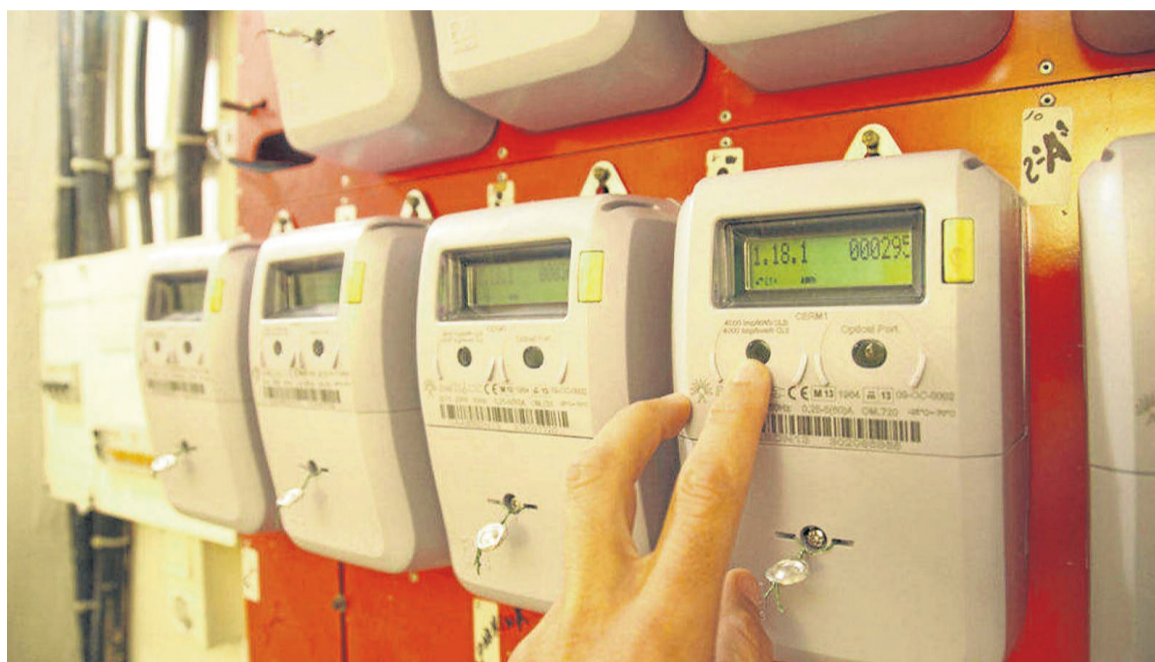
Un técnico revisa una fila de contadores de la luz de un edificio de viviendas.
