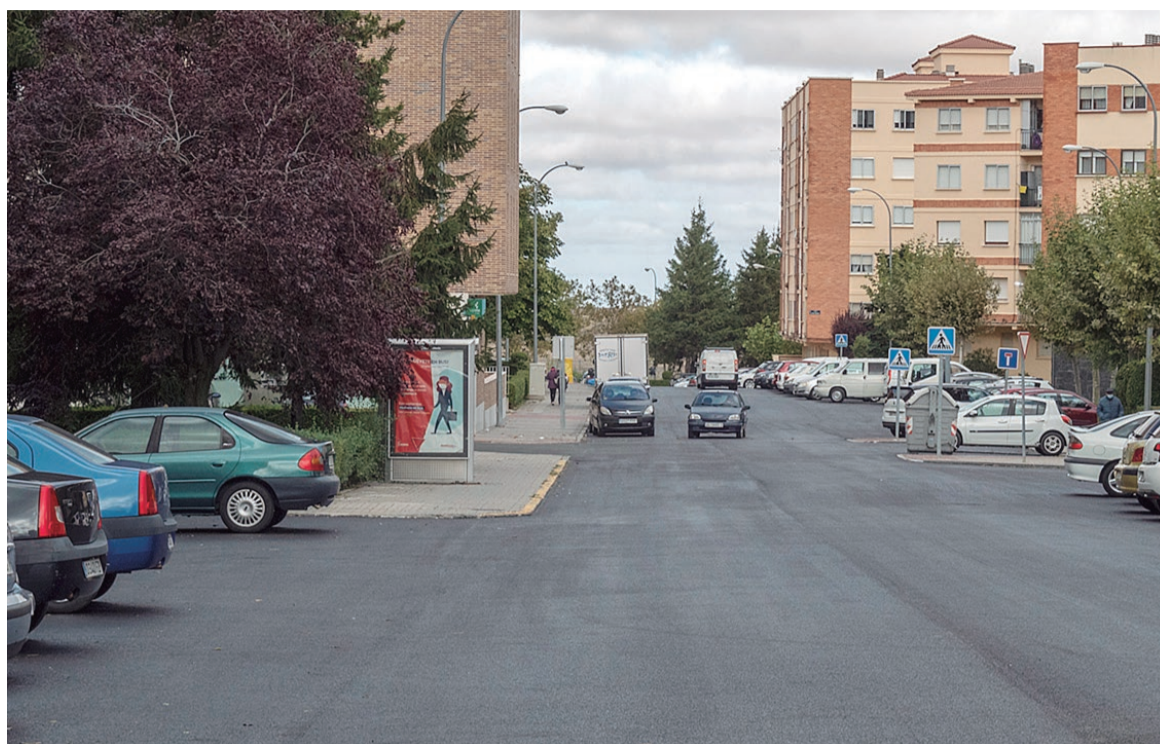
El plan de asfaltado ha mejorado más de 20.000 metros cuadrados en varias calles de la capital.
