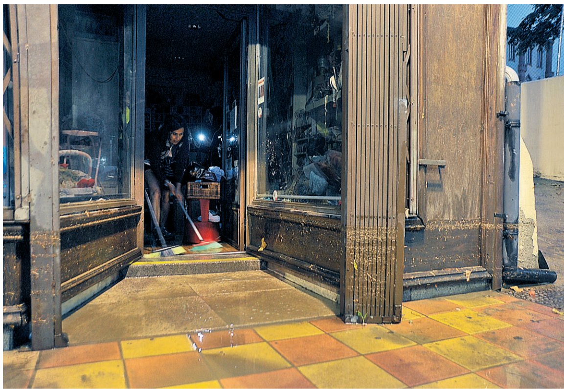
Un local de la plaza de Somorrostro resultó inundado el pasado agosto como consecuencia de la lluvia.
