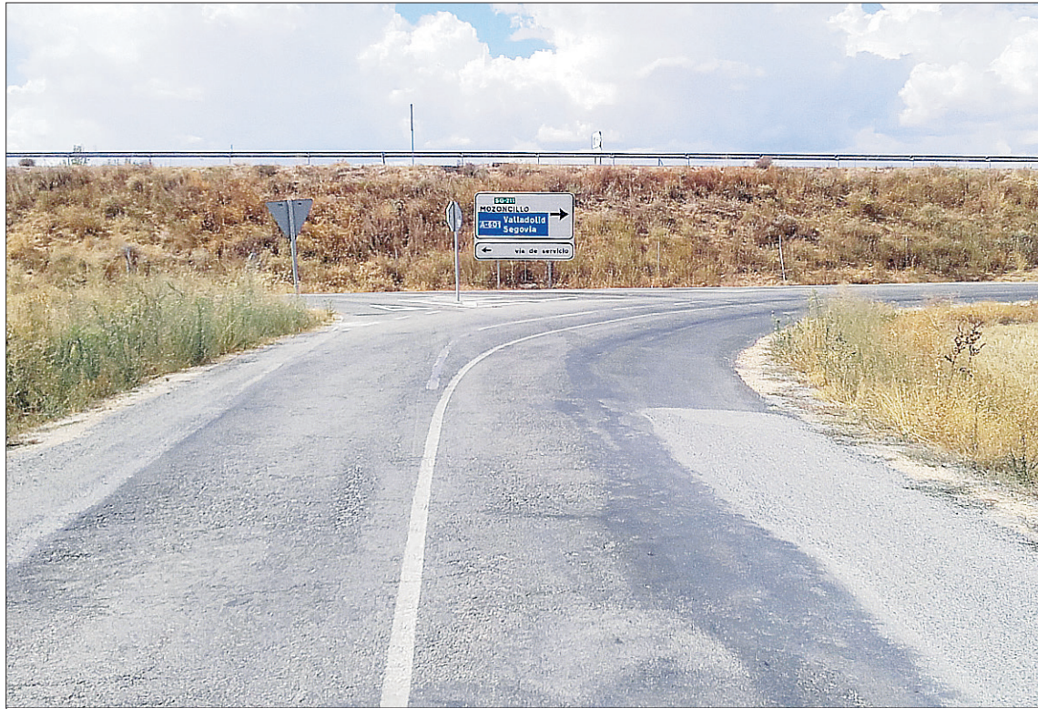
El mal estado de la vía ha hecho necesario realizar diferentes obras de reforma en esta carretera. / EL ADELANTADO
