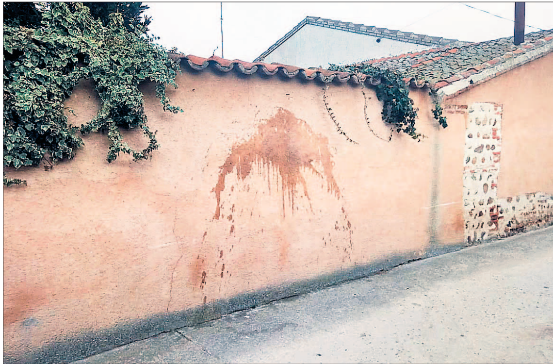
Las manchas en las fachadas de las viviendas aparecieron en distintas ocasiones. / EL ADELANTADO
