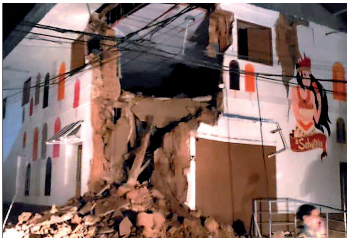
Imagen facilitada por los bomberos de Perú donde se ven los daños causados por el seísmo en Yurimaguas. / EFE
