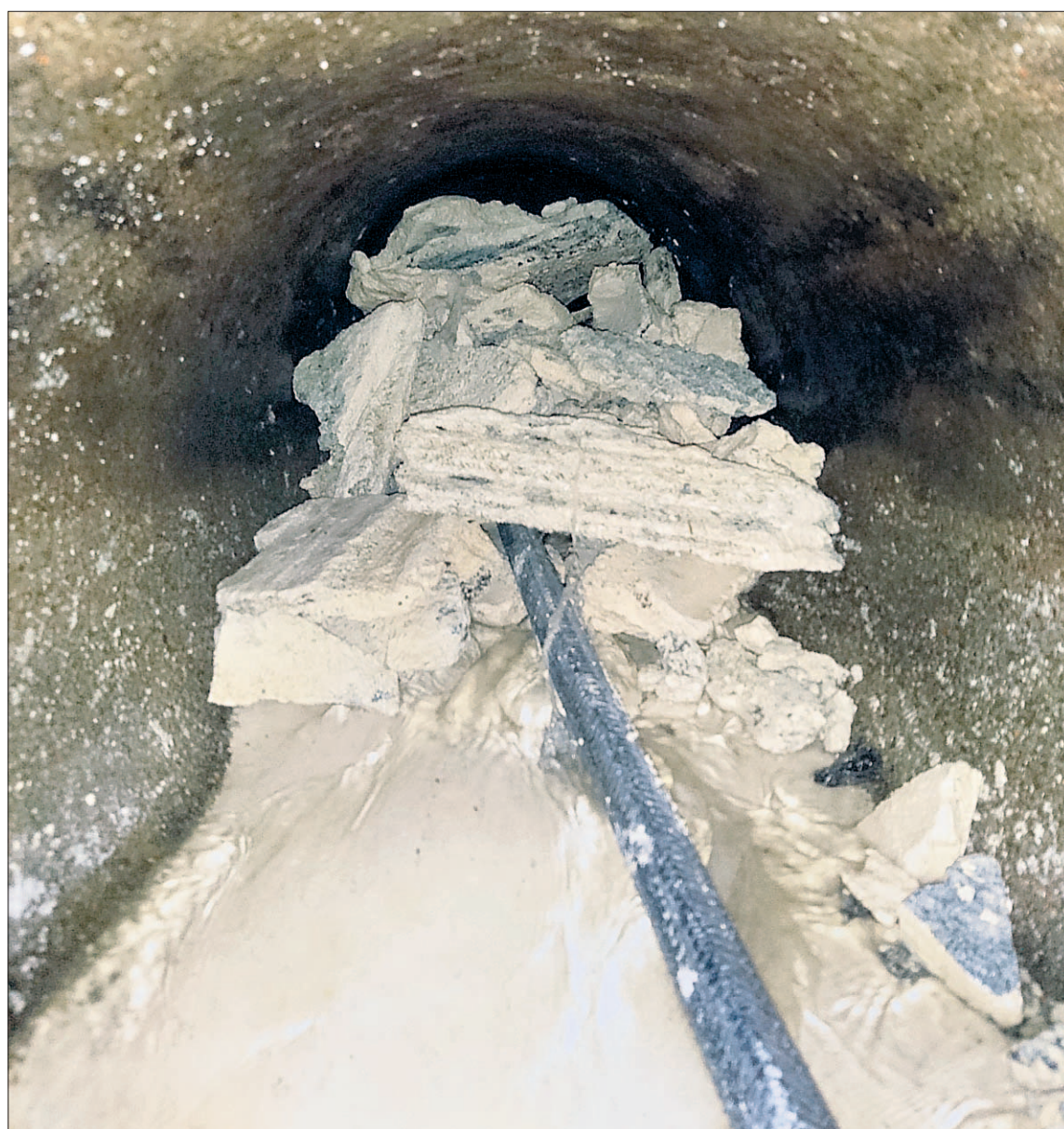
Colector del paseo del Salón con bloques sólidos formado por la mezcla de grasa y detergentes jabonosos. / E. A.
