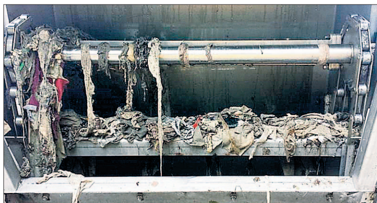
Plásticos y telas pueden generar averías en la estación depuradora. / E. A.
