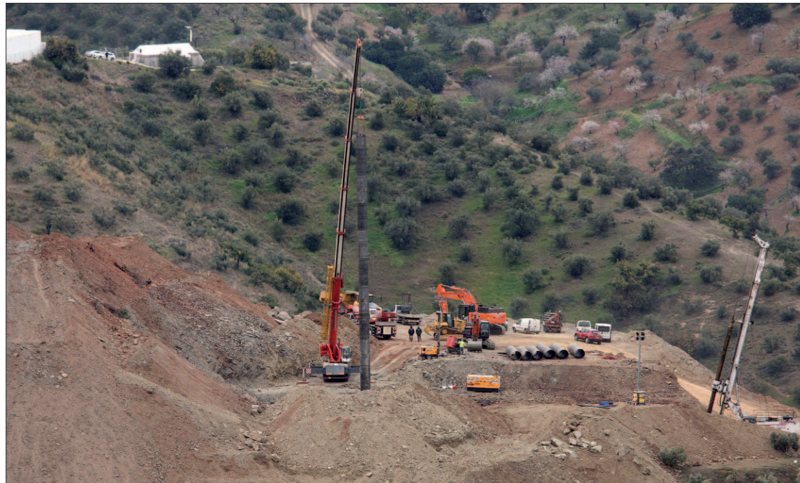
Finalizan las obras de ensanche del túnel vertical paralelo al pozo donde cayó el niño Julen. / EUROPA PRESS
