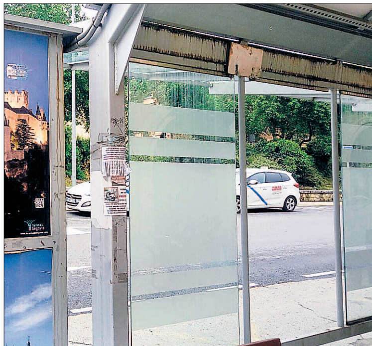
Marquesina de los autobuses urbanos de la ciudad en mal estado. / E. A.
