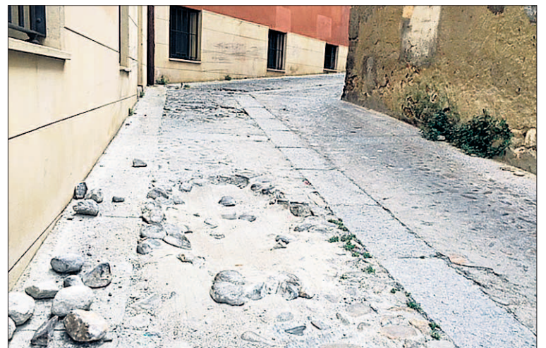
El Ayuntamiento anuncia la reparación de la calzada de esta calle de María Zambrano.
